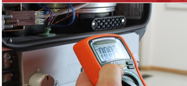
Revízie kotlov a revízne správy
